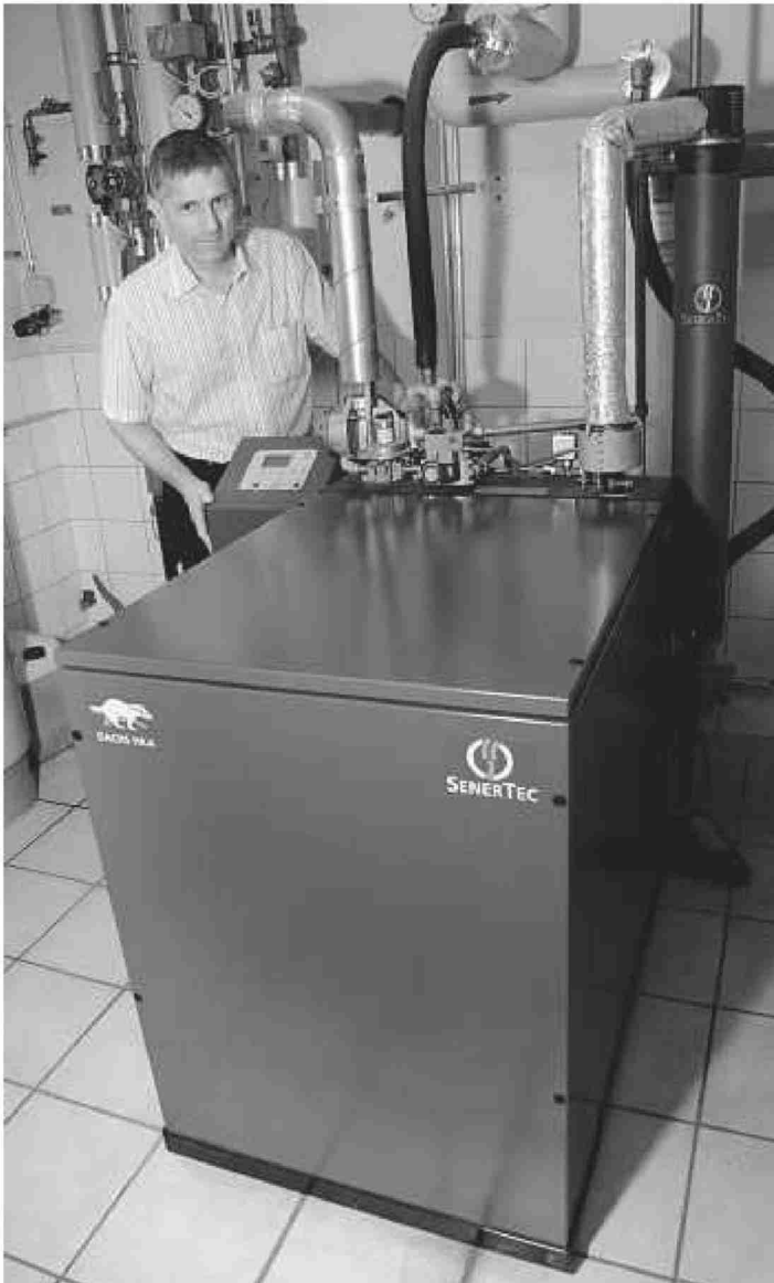
40 000 Franken kostet eine solche Wärme- und Stromkraftkopplungsanlage – im Bild ein Exemplar von einer Bieler Firma.
