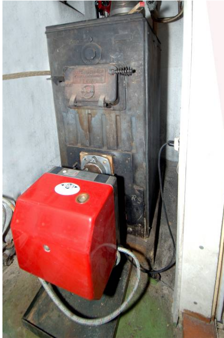
Légende: La chaudière Zent située à Klosters, datant d'env. 1910 (charbon) et fonctionnant au mazout depuis env. 1930.
