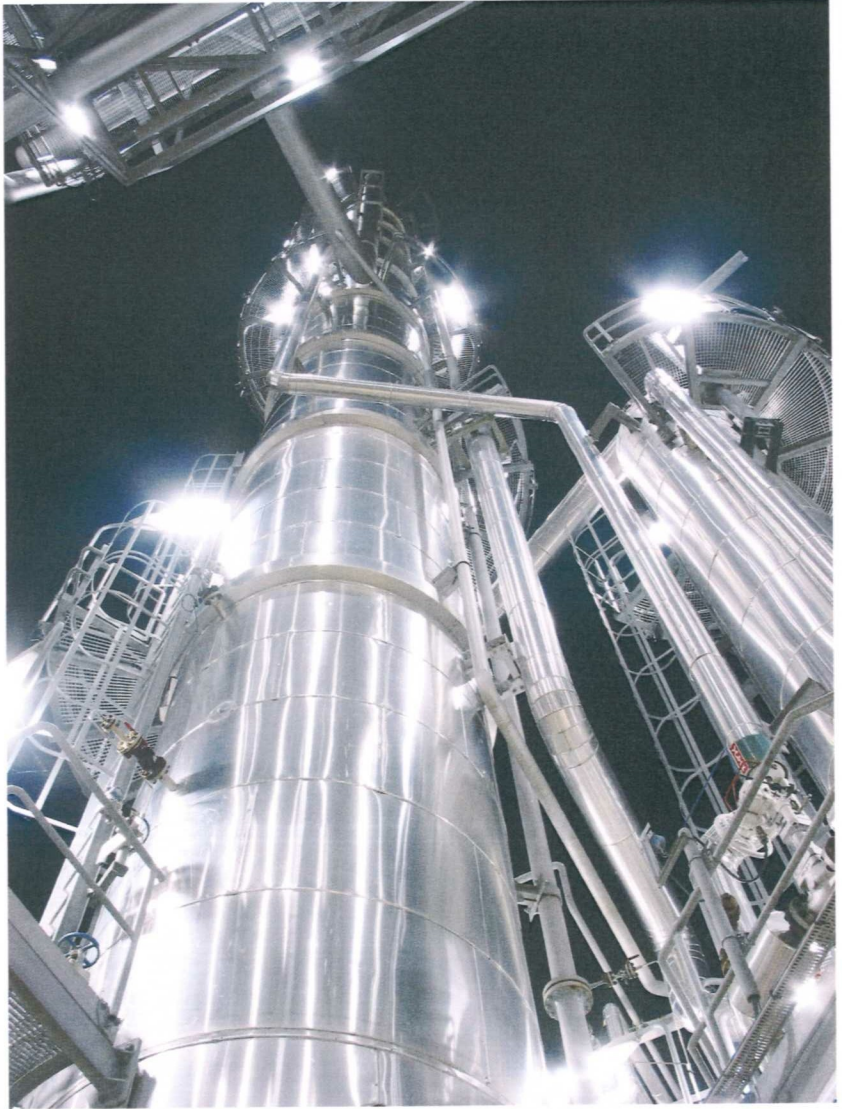
Légende: Vue de l'installation de désulfuration de la raffinerie de Cressier. (Photo: Petroplus SA)
