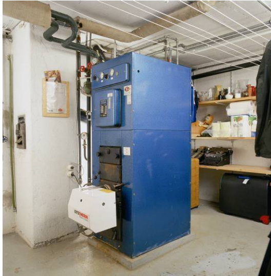
Bildlegende: Alte Ölheizungen nehmen viel Platz weg und verlieren an Wärme.
