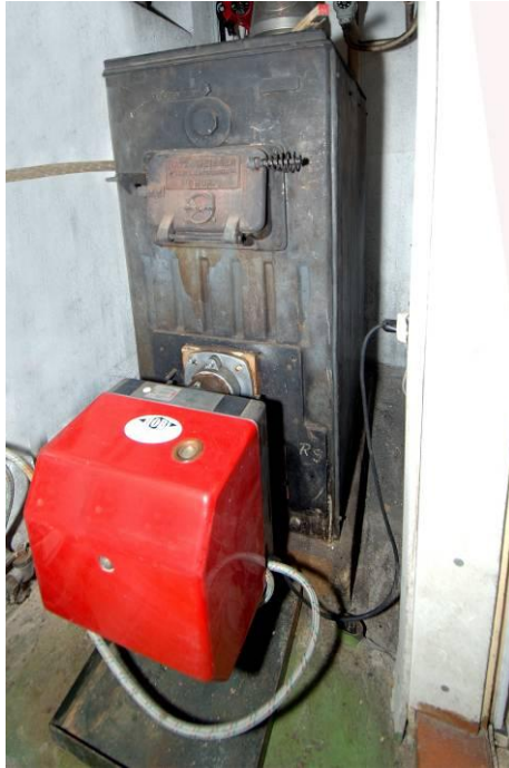
Bildlegende: Der Zent Heizkessel aus Klosters. Ca. Jahrgang 1910 (Kohle) und ab ca. 1930 mit Ölbetrieb.
