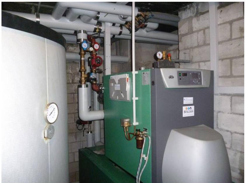
Bildlegende: Die Ölbrennwertheizung und der Boiler versorgen das Mehrfamilienhaus mit Wärme und Warmwasser. (Quelle: EV)
