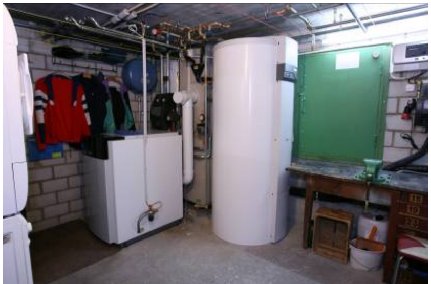
Légende: Vue sur la chaufferie avec la nouvelle chaudière au mazout à condensation, le groupe mélangeur, le tube de cheminée bidirectionnel, l'accumulateur solaire, la régulation et les pompes solaires en cascade.
